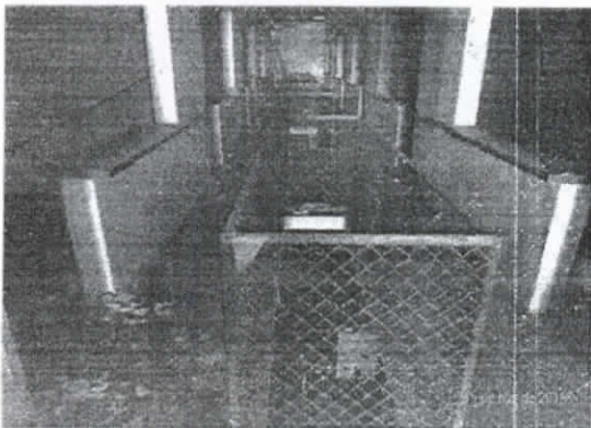
GRADE DE PROTEÇÃO EM FERRO
