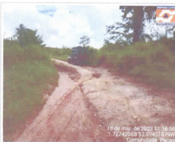
Uma fissura na Comunidade de Pacas
