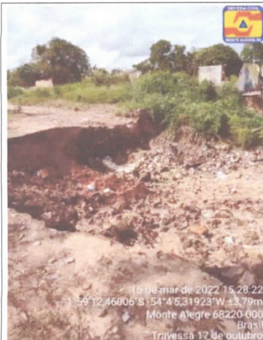
Travessa 17 de outubro, pajuçara teve parte da via destruída.
