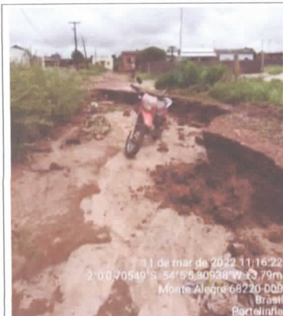
Travessa Laura Lins, teve parte destuida pela força da enxurrada.
