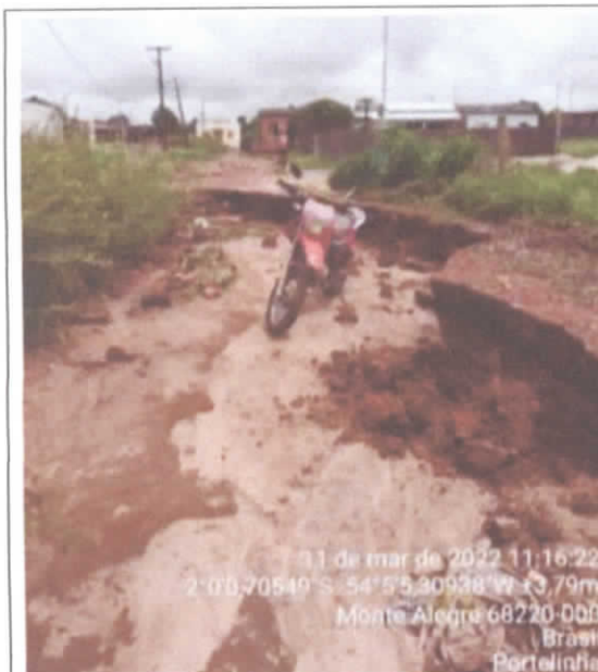
Travessa Laura Lins, teve parte destuída pela força da enxurrada.
